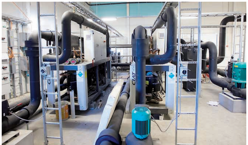
Kuvassa näkyy kauppakeskuksen jäähditysjärjestelmä.
